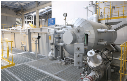
ボイラ 焼却炉より送られてきた排ガスの熱を利用して蒸気をつくります。
