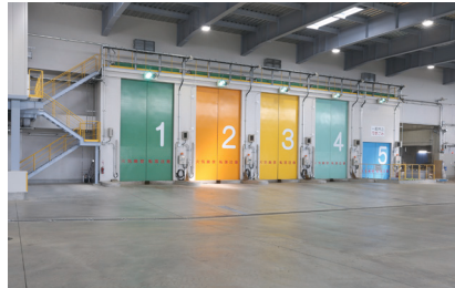
プラットホーム ごみ収集車や一般の搬入車両は計量機で重さを量ってからプラットホームに入場し、5つのごみ投入扉からごみビットにごみを投入します。
