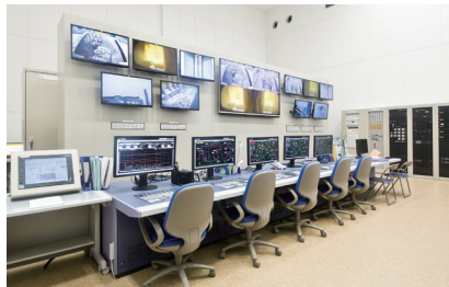
中央制御室 施設全体の稼働状況を管理します。機器の状態や処理の状況を画面上で監視し、安全で効率の良い運転制御を行います。
