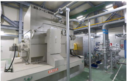
蒸気タービン発電機 ボイラで作られた蒸気を利用して発電し、施設内の電力として使用するとともに、余剰電力については売電します。
