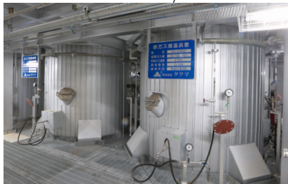
排ガス減温装置 エコノマイザを通してきた排ガスの温度を急速に冷却し、ダイオキシン類の再合成を抑制します。
