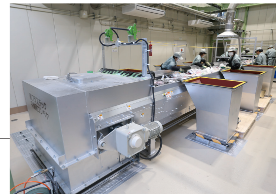
手選別コンベヤ 手作業により資源物と異物を選別します。
