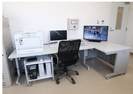
管理室 施設全体の処理ラインを管理します。機器の状態や処理の状況を画面上で監視し、安全で効率の良い運転を行います。
